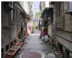
鄰棟間隔不足，不利消防救災
